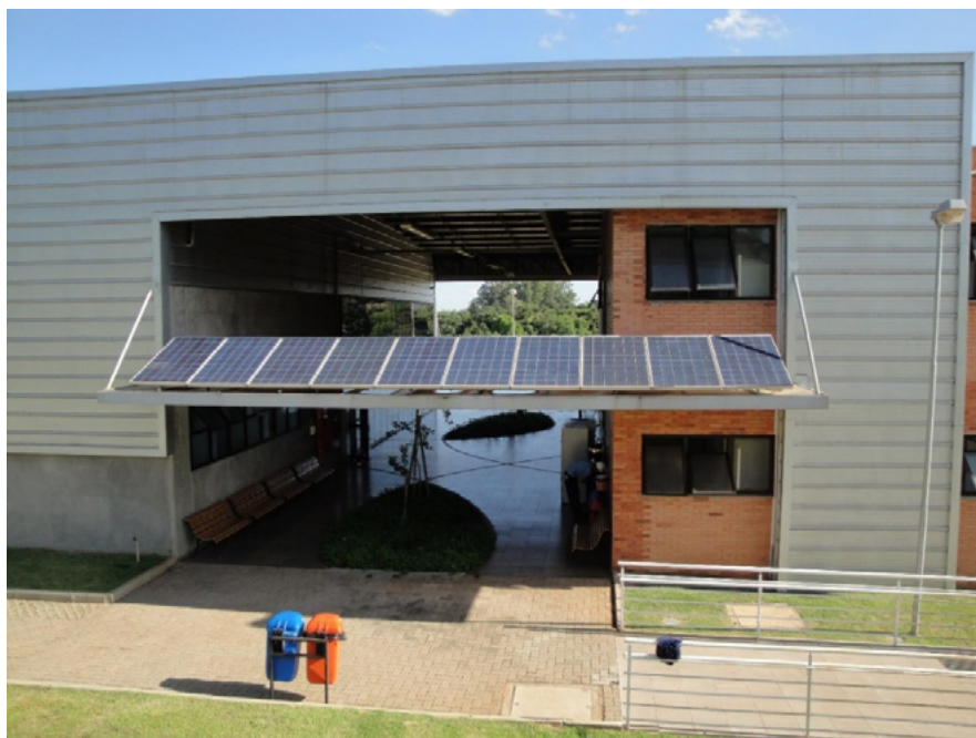
Figura 1 - Módulos fotovoltaicos instalados no prédio 17 da Univates
