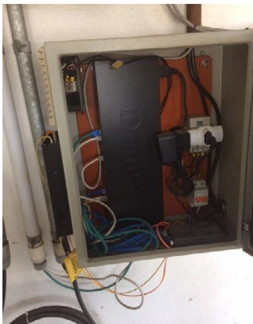
Figura 6 – Switch de Rede Ethernet e Pontos de Derivação.
