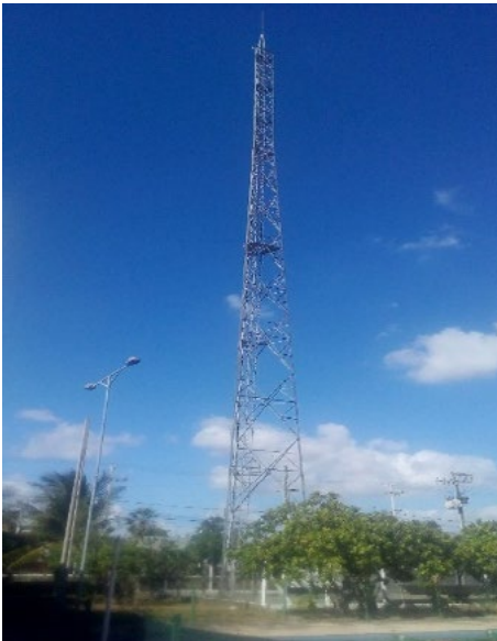
Figura 2 - Torre de telefonia, localizada no IFCE campus Maracanaú
