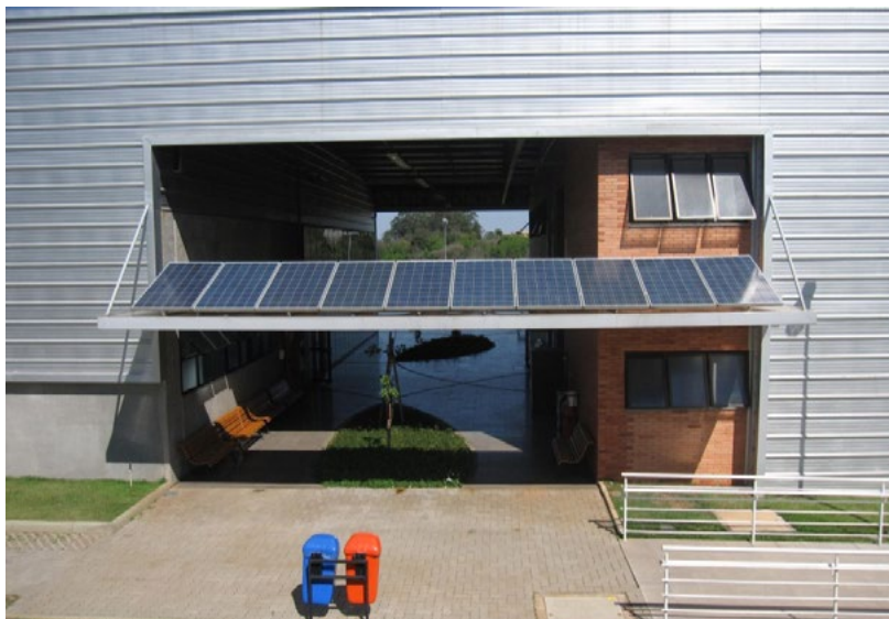
Figura 1: Painel Solar Fotovoltaico
