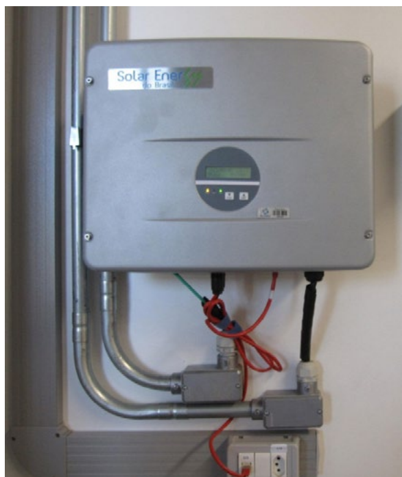
Figura 2: Inversor responsável pela conversão da corrente contínua em alternada
