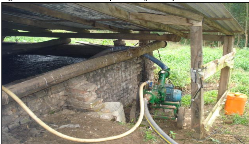
Figura 6 – Unidade de Recalque do Dejetos Líquido de Suínos.
