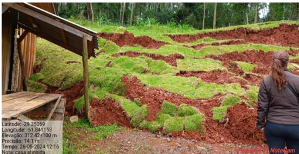
Figura 7 - Escorregamento Rotacional em Colinas/RS
