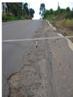
b) Afundamento local
