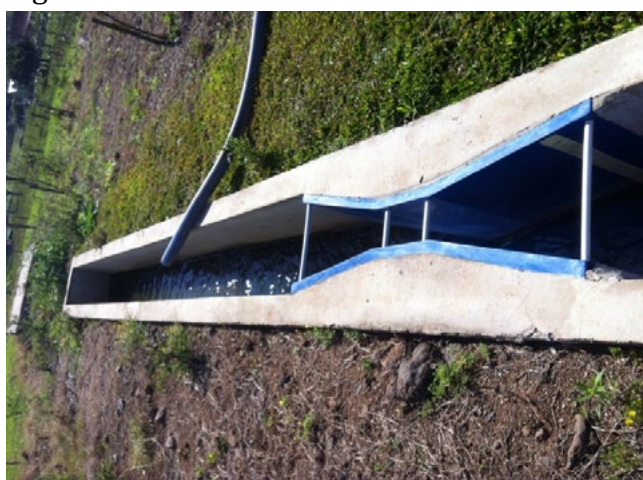
Figura 1: Calha Parshall de saída do efluente tratado
