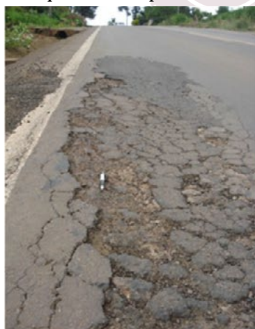
b) Panela, trinca interligada “couro de jacaré”
