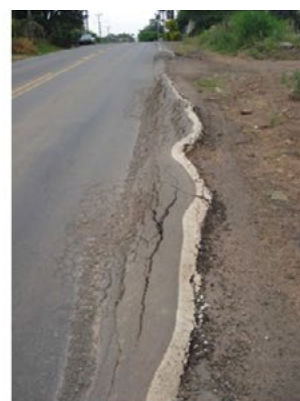
d) Afundamento nas trilhas de roda
