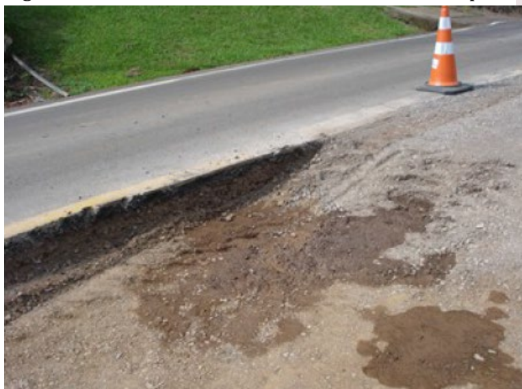
Figura 8. Problema com umidade nas camadas do pavimento
