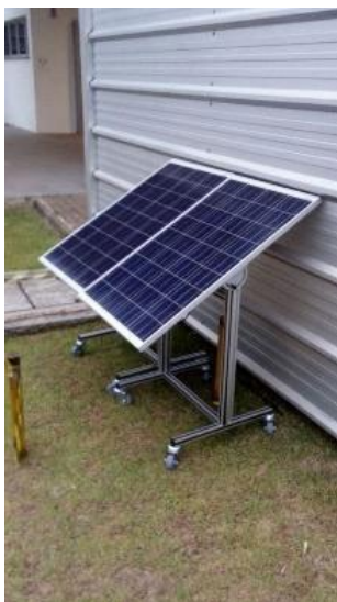
Figura 1. Localização dos painéis fotovoltaicos, Prédio 19.
