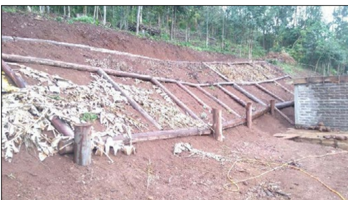
Figura 9: Grade viva montada em encosta seca, aguardando o plantio nos espaços, aplicada em talude seco no município de Arroio do Meio, RS
