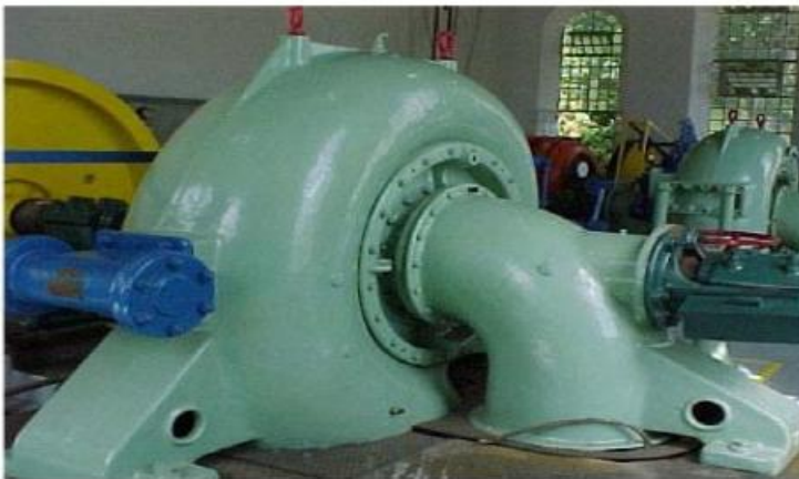
Figura 12: Casa de Máquinas
